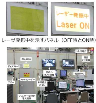
入退管理システム設置機器の様子
