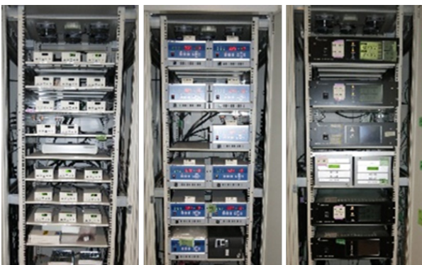
図 4: 電源棟ラック内コントローラ群.
