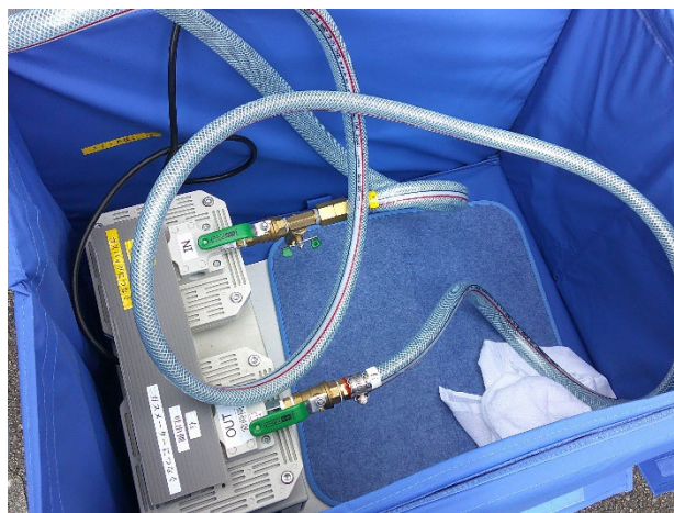
図 17 ダイヤフラムポンプ保管箱の内部の様子
