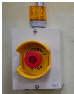
図 4 非常停止ボタンと回転灯
