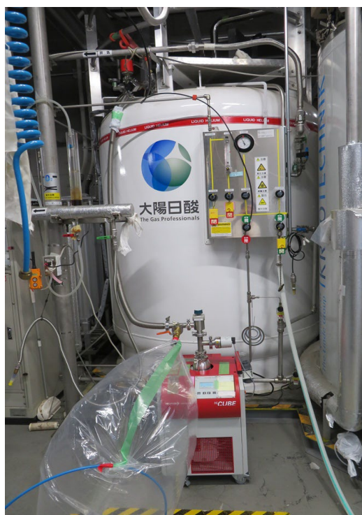
図2 ヘリウム貯槽昇温時の様子 (手前の袋は真空層に充填する用の窒素ガス)
