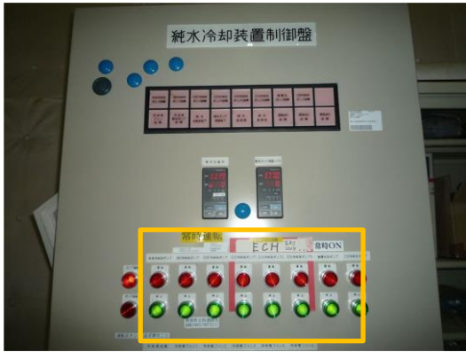
図 8. 冷却水ポンプ制御盤の 運転・停止ボタン（8系統）
