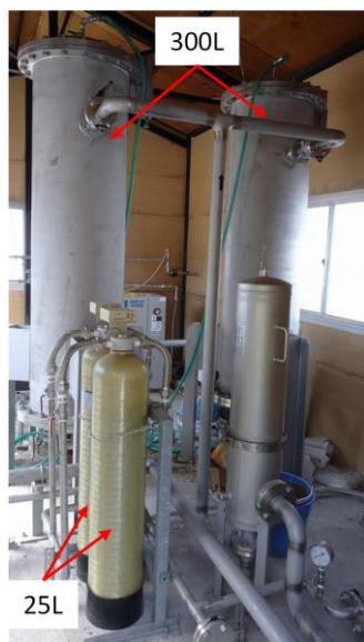
図1. 既設イオン交換樹脂塔 （プレハブ小屋内）
