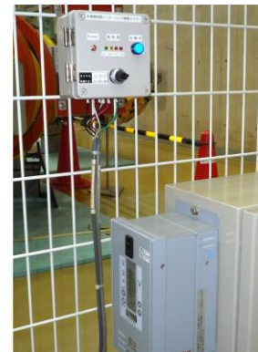
図4. He 液化冷凍機室 (ガスポンプステーション2)
