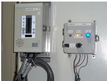
図2. コイル電源室 (1)
