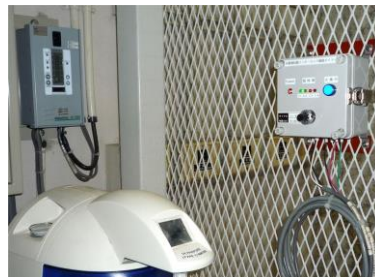
図3. He 液化冷凍機室 (ガスポンプステーション1)
