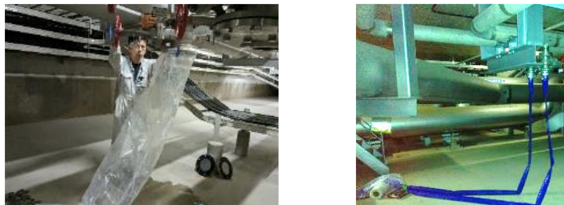
図 1. 地下共同溝での排水
