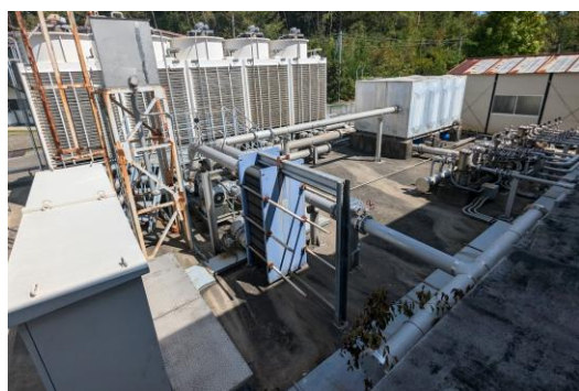
図 1. 開発棟冷却水設備の外観
