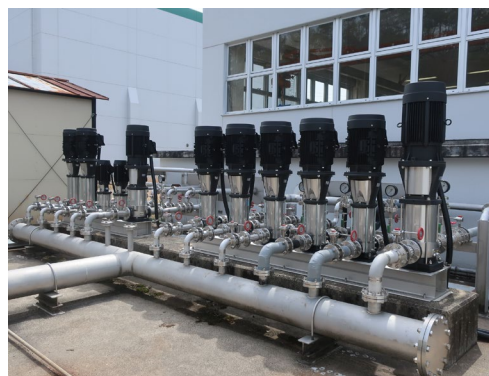
図4. 更新後の1次冷却水用ポンプ
