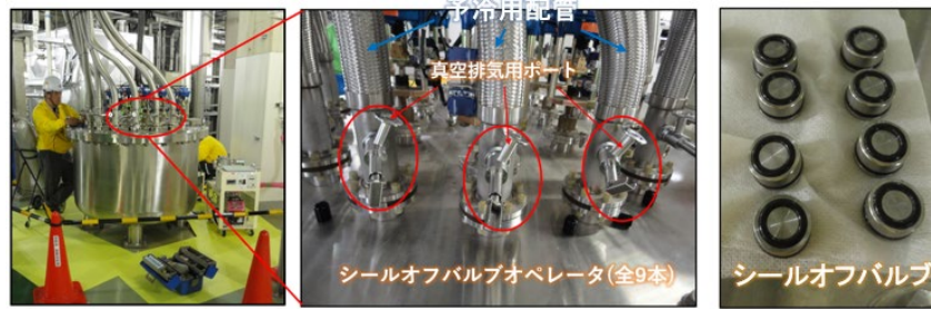
図7. バスライン予冷用断熱二重配管シールオフバルブの交換 左図：作業の様子、中央及び右図：シールオフバルブの詳細
