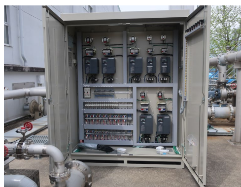
図5. 新設したインバータ盤（片面）
