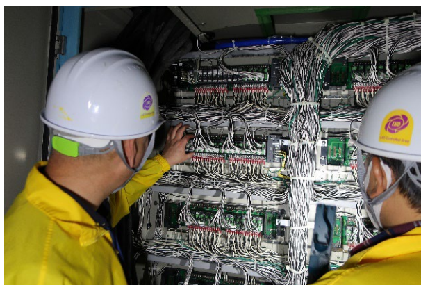
図 1. 現場盤の年次点検
